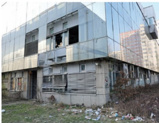
Zaradi poškodb stavbe in neustreznega vzdrževanja bi morali po grobih ocenah v obnovo objekta vložiti dodatnih 5,55 milijona evrov. Foto: Primož Lavre
